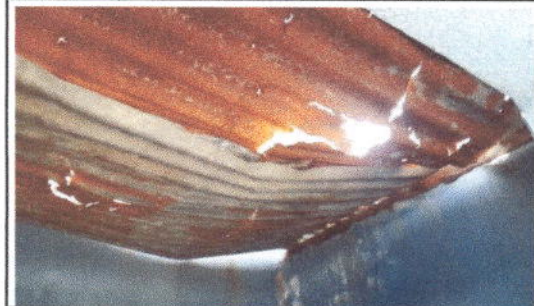
FOTO 1: Sustitución de lámina, por lámina troquelada aluzinc calibre 26 Y Sustitución de estructura de soporte por metal EN BAÑOS
